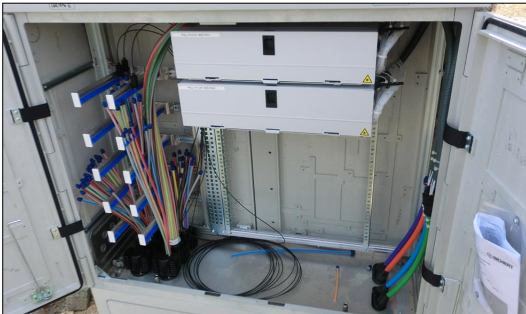
Abbildung 5: Beispiel Innenaufbau eines Netzverteilers (erstellt durch BBA)
