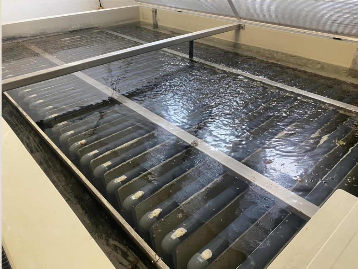
Bestehende Vakuum-Anschwemmfiltration mit Filtertüchern aus dem Jahr 2009
