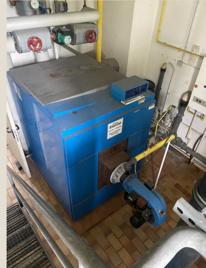
Gas-Heizkessel aus dem Jahr 1991 mit 530 kW
