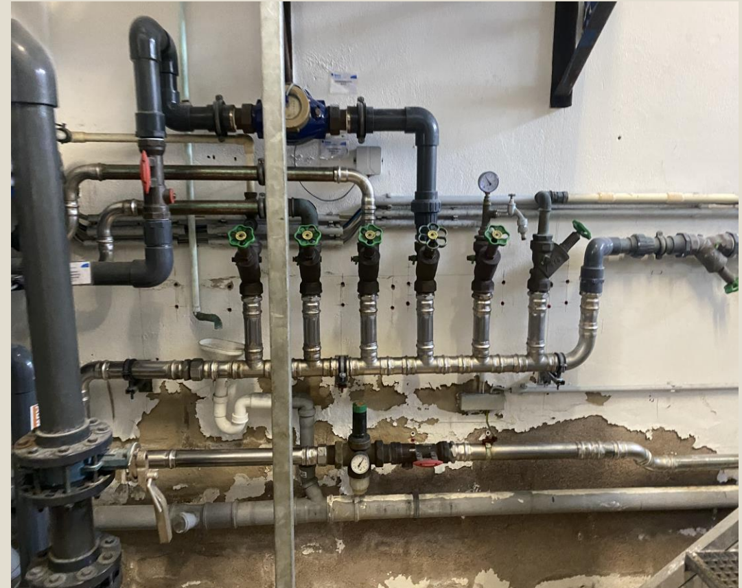
Vorhandene, teilweise erneuerte TW-Installation
