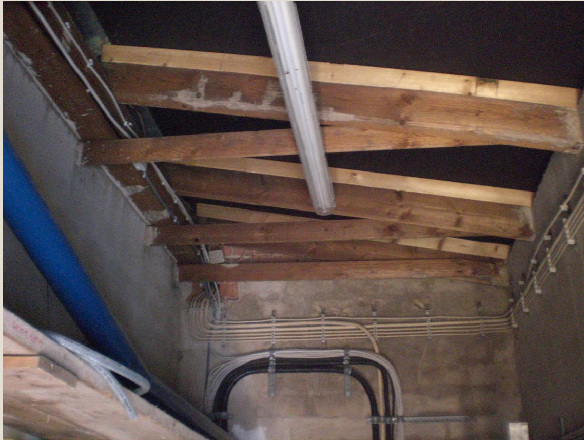
Dachraum offen im Hausanschlussraum
