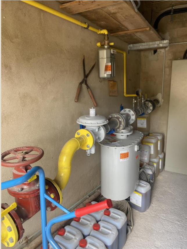
Hausanschluss Gas (Lagerung von Chemikalien)
