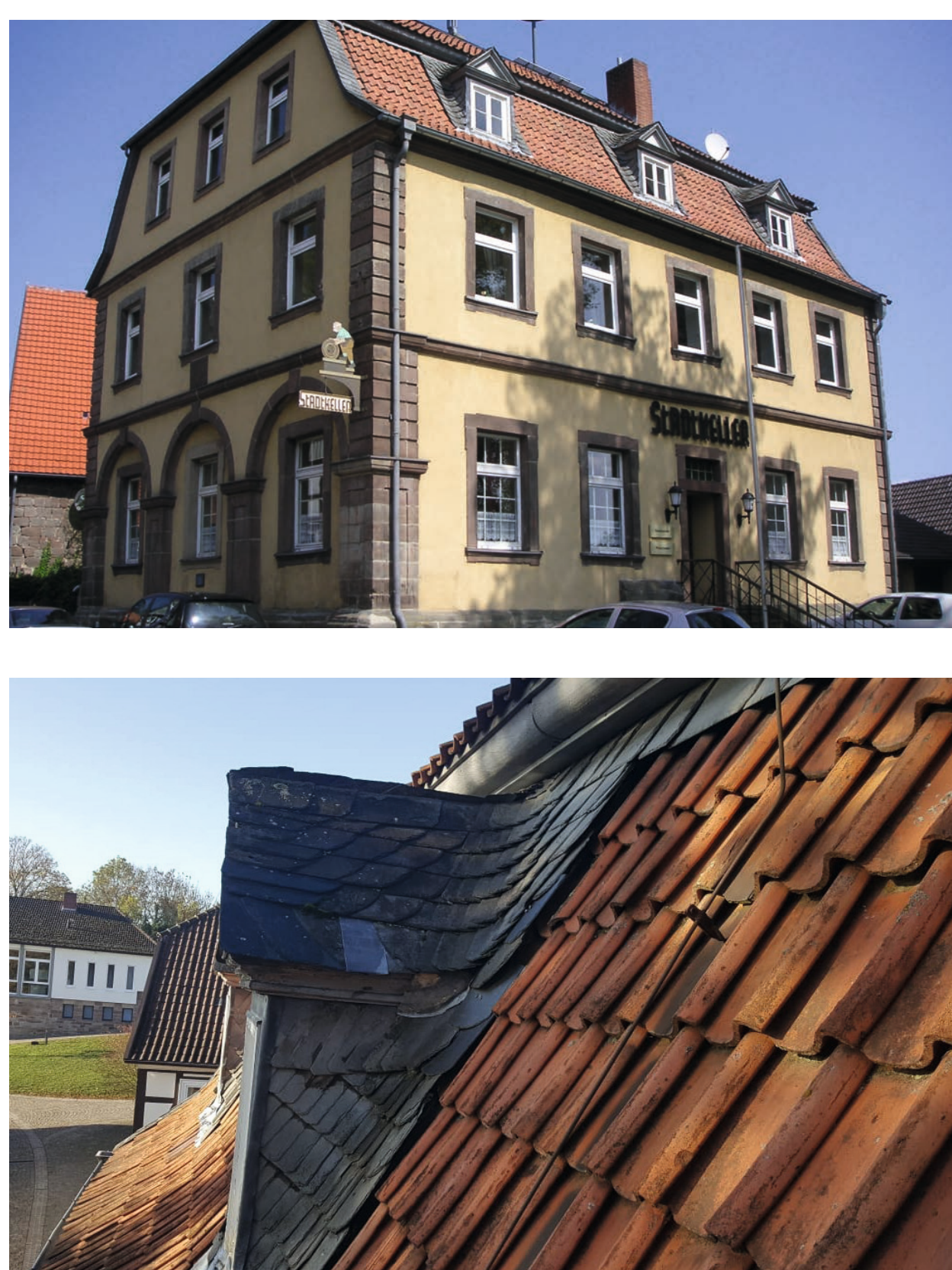
Gesamtansicht und Detail Dach vor der Sanierung.
